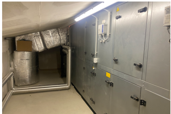
Abb. 5: Lüftungszentrale im Dachboden
