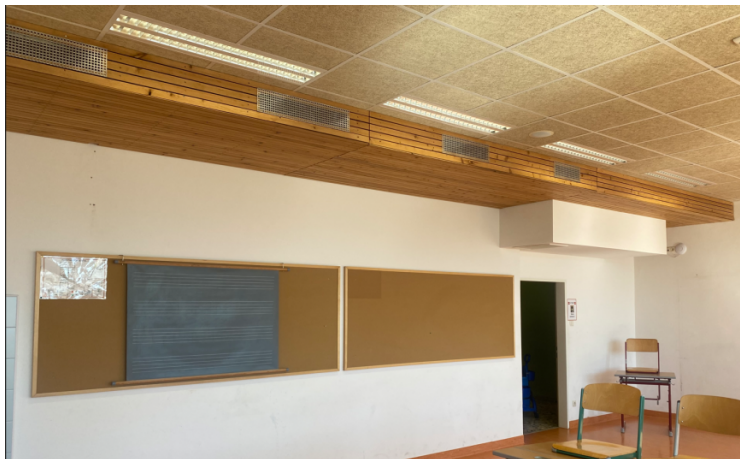
Abbildung 8: Klasse mit Zuluftgittern und Überströmung
