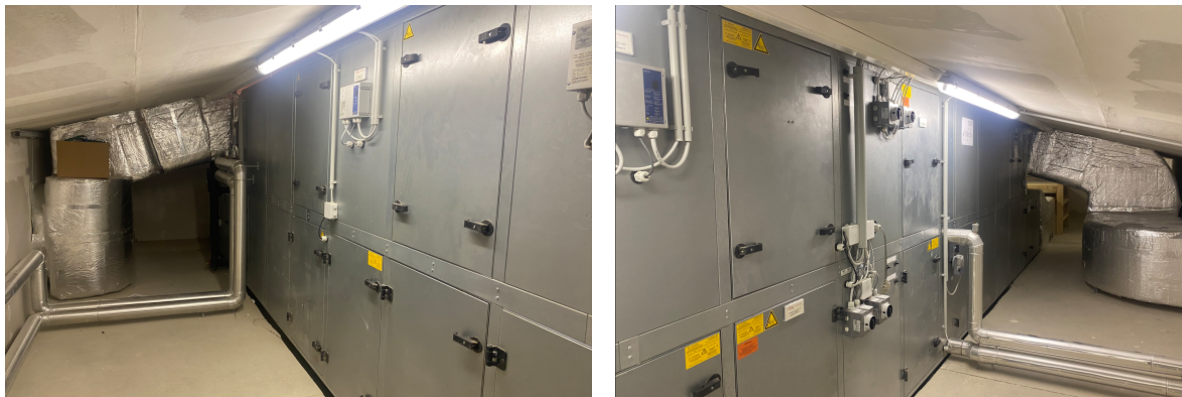
Abbildung 14 und 15: Lüftungszentrale im Dach
